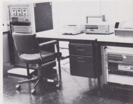
Salle contrôle vide thermique
