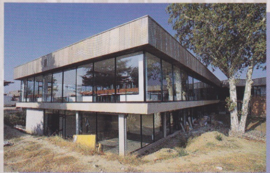
Bâtiment S : l'extension de la salle du restaurant est terminée ; la laverie est en cours d'essai, avant le remplacement de l'ancien système. Autre extension de salle pour les locaux du CE : livraison effectuée.
